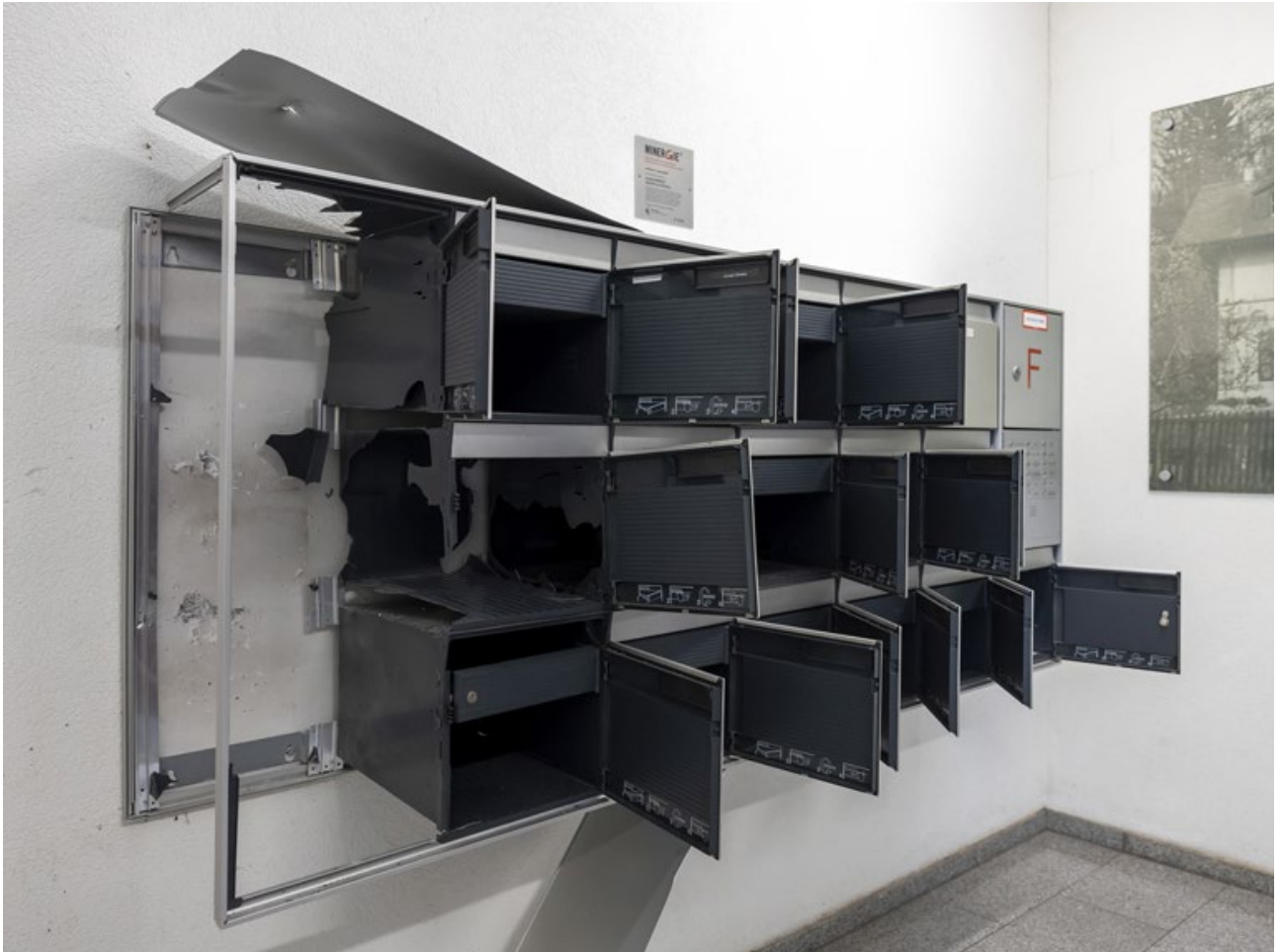
Die Detonation zerstört die Briefkästen des Wohnhauses, ein Kind wird verletzt.
